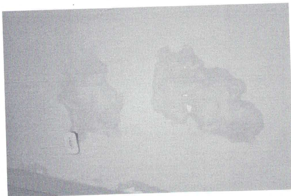
Foto 12. Vista interna ampliada da parede posterior do prédio (limite do lote). Manchas de umidade e caixa de tomada desafixada recebendo umidade.
