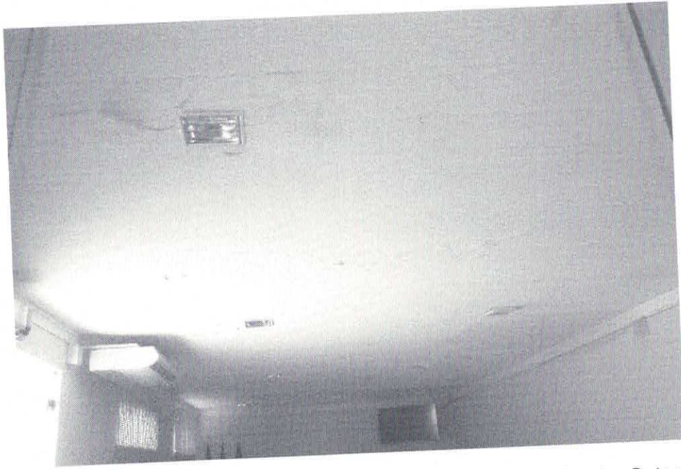
Foto 05. Forro do plenário, com manchas de umidade no forro e no roda teto. Deterioração das placas de gesso e da pintura
