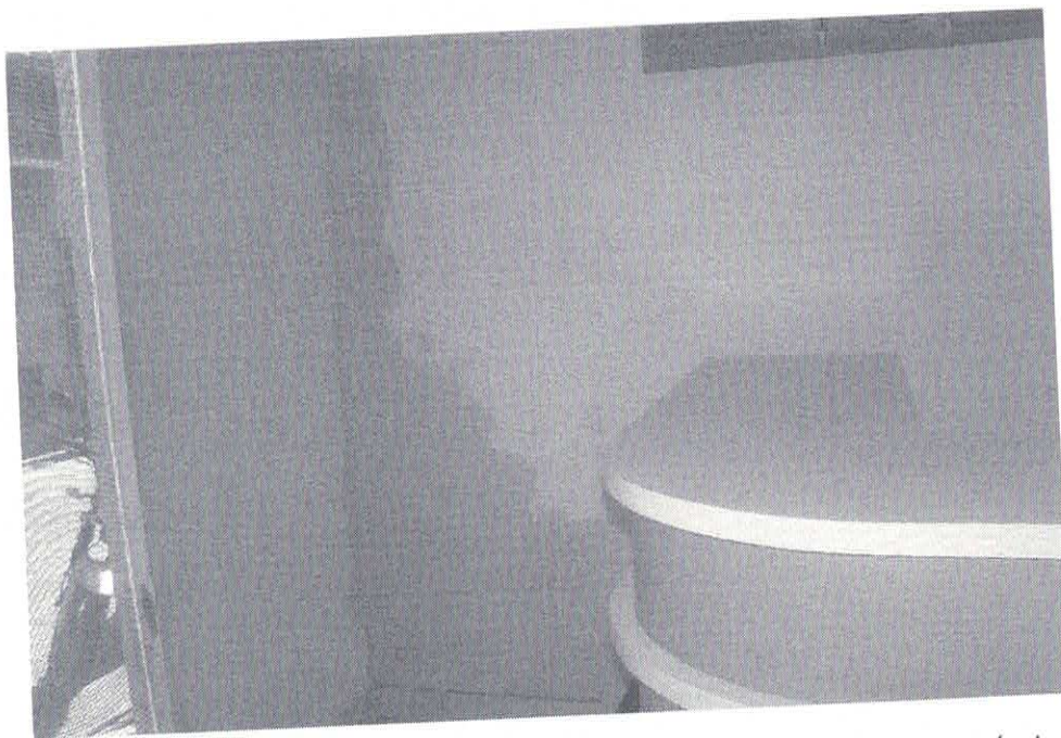
Foto 01. Vista da recepção do imóvel, com manchas de umidade visíveis.
