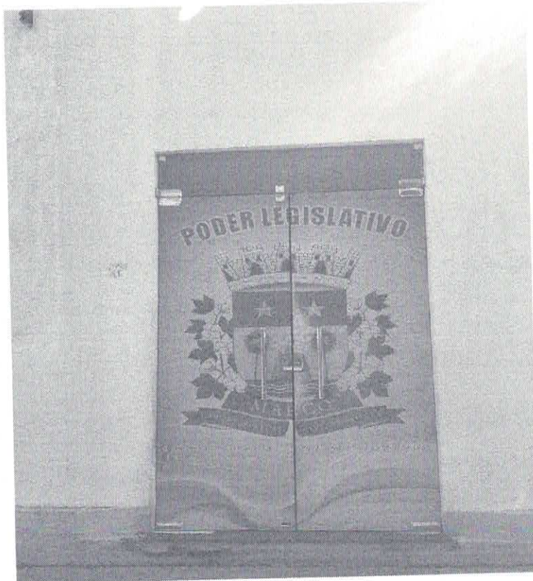
Foto 16. Vista ampliada da fachada frontal (recepção), com manchamentos da pintura e manifestações de umidade no canto inferior esquerdo da porta.
