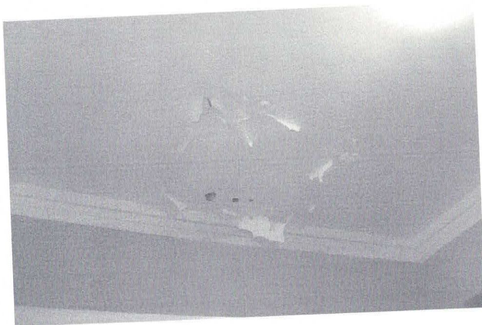
Foto 02. Deterioração da pintura e da placa de gesso do forro do banheiro feminino. Como também, presença de manchas de umidade.
